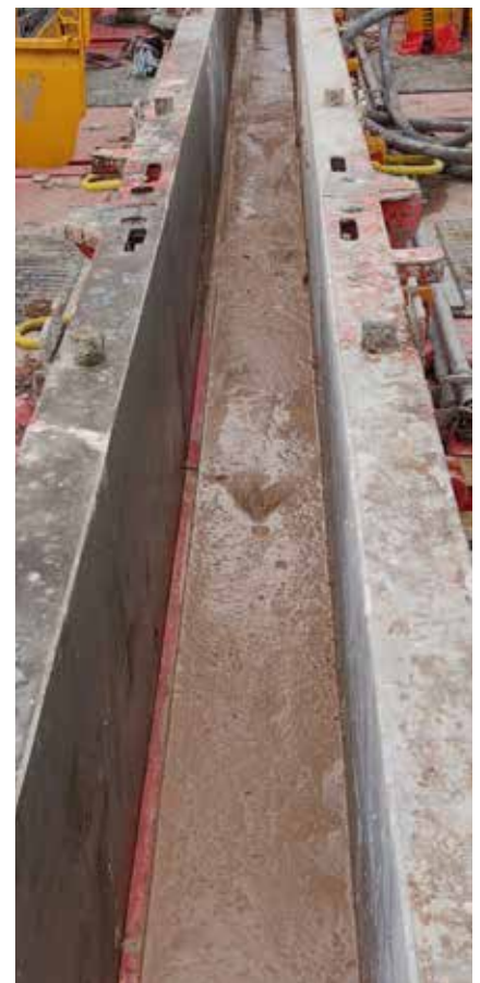
Coulage d'un mur en BARBE dans les banches et mise en place à l'aiguille vibrante
